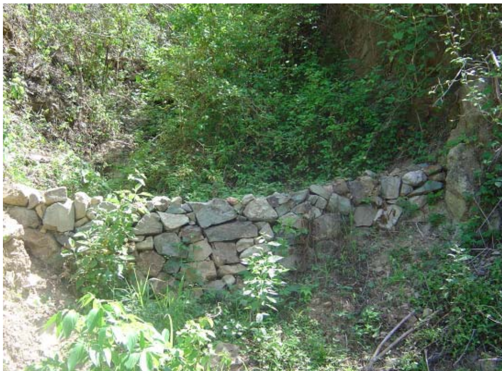
Dique construido en la zona de recarga hídrica de la fuente Los Cuevones, San Pedro del Norte
